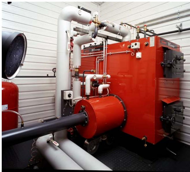
Kuva 4.6. 200 kW:n vesijähdytteinen stokeripoltin. Koko järjestelmä on rakennettu siirrettävään konttiin.
