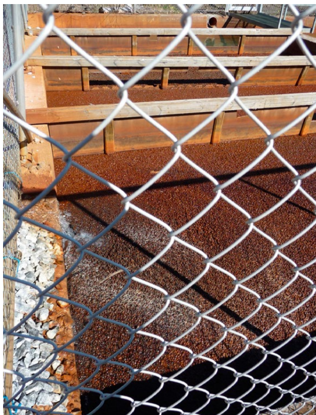
Kuva 14. Passiivista vesienkäsittelyä. Kuva: © T. Kauppila, GTK. Fig. 14. Passive water treatment structures. Photo: © T. Kauppila, GTK.
